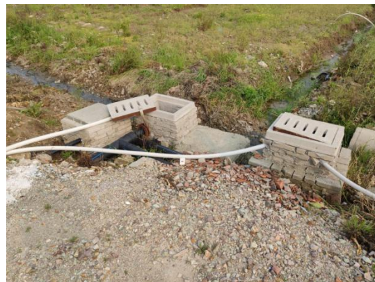
生活污水排放口
